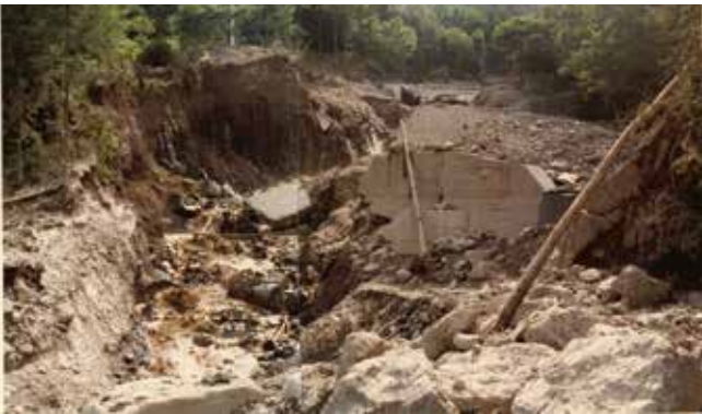
南アルプス林道沿いの曽根沢で地山が洗掘され既設谷止工の袖部が流失
