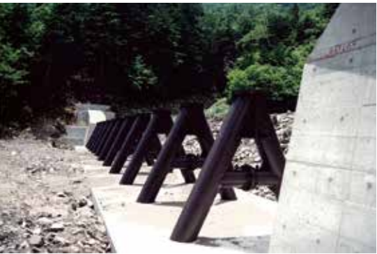
巨石、流木の流下を防止するスリットダム
