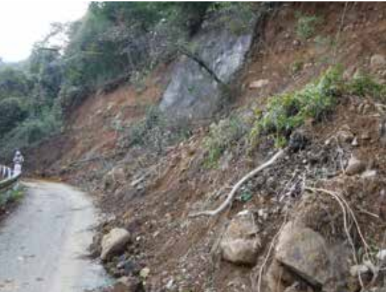
既設法面の崩壊
