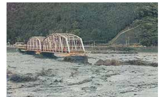
富士川に掛かる南部町の万栄橋が流失 出典:山梨県 昭和五十七年 昭和五十八年災害誌
